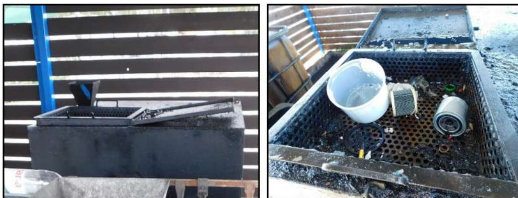
Σίτα επί του στομίου της δεξαμενής, για την αποφυγή απόρριψης στερεών αποβλήτων εντός αυτής
